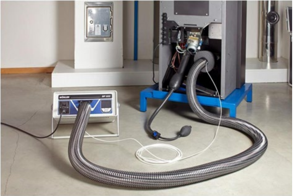
Abb. 62: Aufbau für die Ofendichtheitsprüfung. Anschluss von Luftschlauch mit Abdichtelement am Abgasrohr Feuerstätte sowie Druckanschlusschlauch neben Luftschlauch im Abdichtelement Abgasrohr. Zuluftöffnung an der Feuerstätte mit Abdichtblase oder Abdichtelement abdichten.
